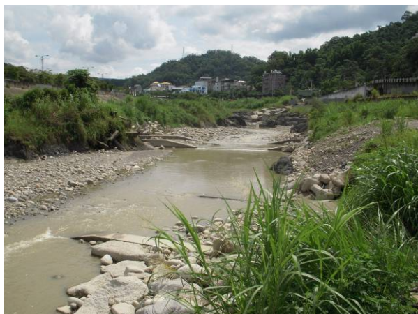
大坑溪上流（河床洗堀の状況）（台中）
